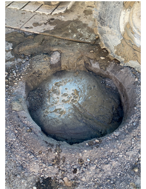
Verfüllte Bohrung zur Beseitigung des Ankerfeldes, Bild Guido Meier, Braumann Tiefbau AG
