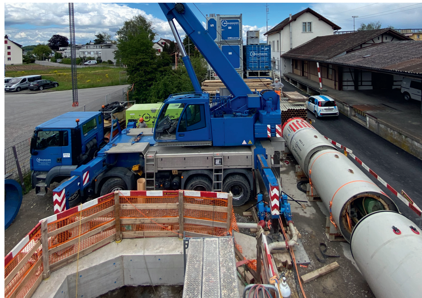
Startschacht und Installationsplatz mit Vortriebsmaschine am Bahnhof Niederglatt, Bild Guido Meier, Braumann Tiefbau AG
