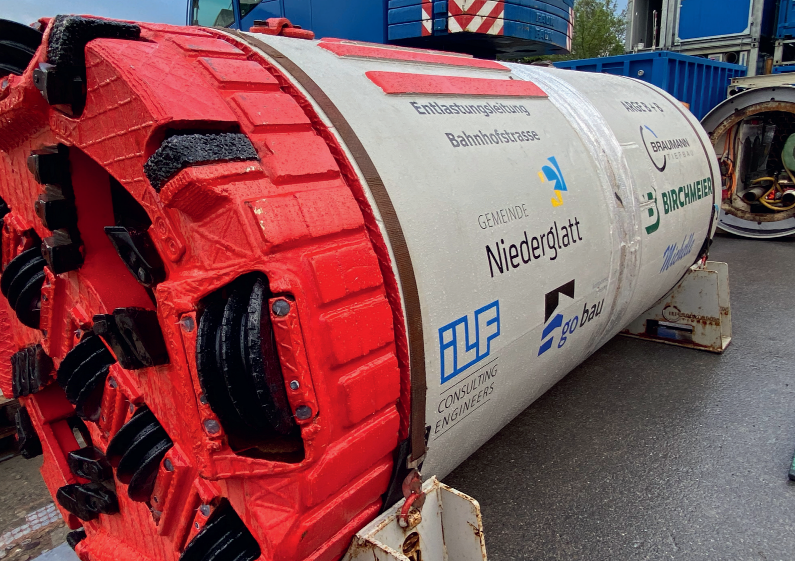
Microtunneling Bohrmaschine für einen Kanaldurchmesser von 1.40m, Bild Guido Meier Braumann Tiefbau AG
