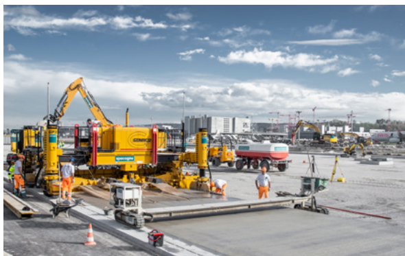
Betonbelagsbau am Flughafen Zürich für die «Stands Delta Süd» (Bild: Specogna Bau AG)
