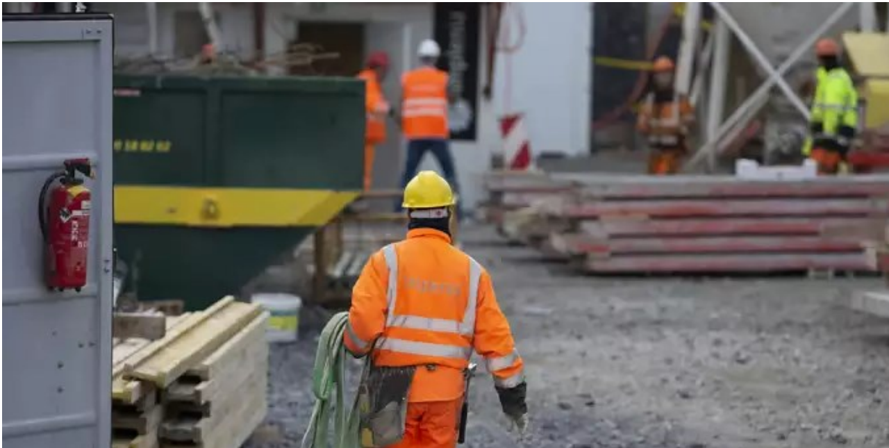
Rückgrat der Wirtschaft auch in Zeiten der Coronavirus-Pandemie: Blick auf eine Baustelle in Freiburg Ende März. - sda - KEYSTONE/PETER KLAUNZER
